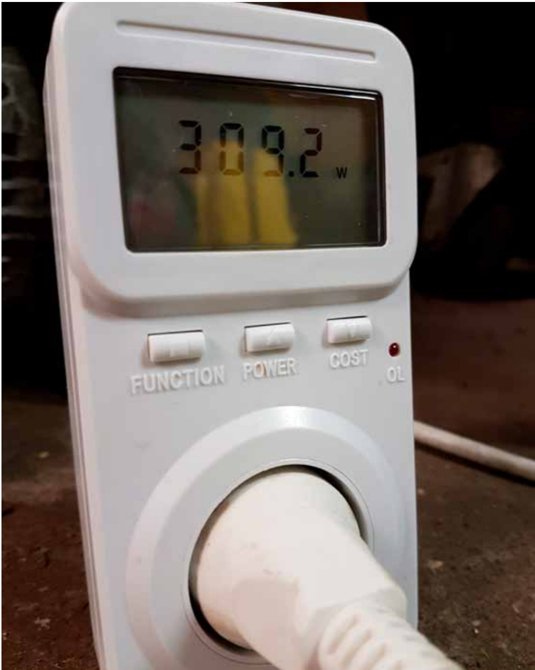
Mynd 6. Hvør RPi sær hefur sín orkugeva (t.d. ein fartelesfonløðara við mikro-USB-inngangi), ið síðani raðvíst er bundin í eykaorkugevar og hvør 4-RPimótul bundin í sama eykaorkugeva.
