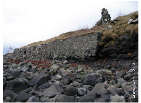
Mynd 9. Undir L kh sfløtti. Verjugarðurin, Jannes b ndi læt gera 1940- runum, fekk skaða uppgangi januar 2008.
